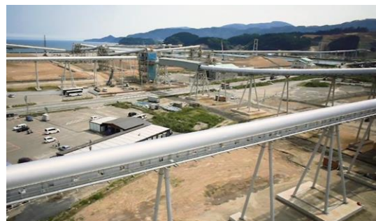
岩手県陸前高田市における土運搬の様子。写真奥の高台から 500 万 m 3 （東京ドーム 4 杯分）の土をベルトコンベアで運搬（現在は撤去済み）。
